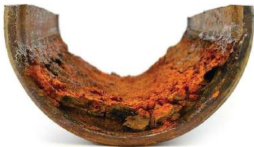
شکل (۲) مشاهدات به عمل آمده از سطح داخلی یک قطعه لوله فولادی بریده شده انتقال آب
